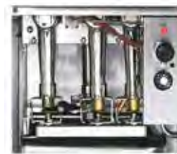
Tubos calentadores (Foto 1)
