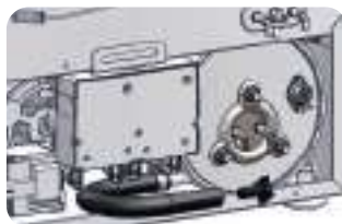
Tubo de desagüe de la caldera independiente
